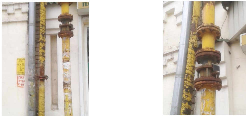
Рис. Нарушение коррозионно-изоляционного и лакокрасочного покрытий участка газопровода в г. Новочеркасске
